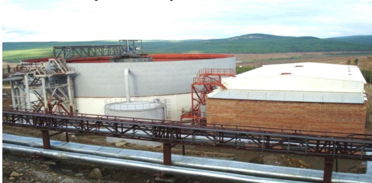
Комплекс сгущения с пульпонасосной станцией
